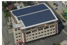
太陽光発電(パシフィックコンサルタンツ/パラオ)
